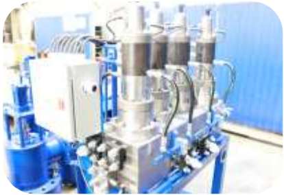
Аппаратура для управления водой высокого давления
