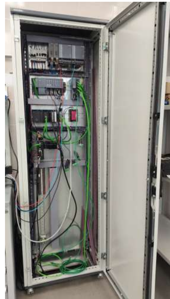
Шкаф (стойка) управления
