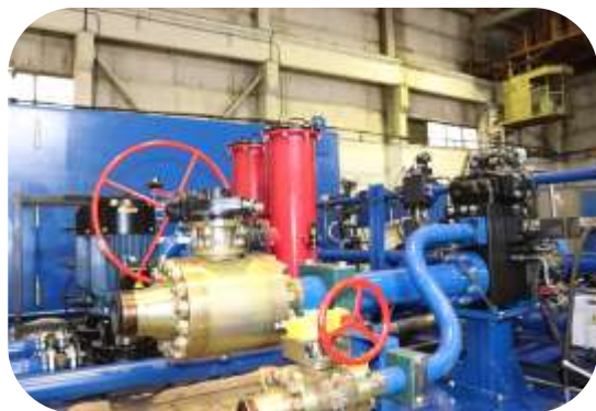
Насосная станция управления механизмами прессы усилием 6300тс. ЭЛ-6
