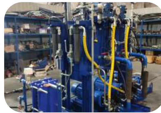
Насосная станция управления следящей системой за кромкой полосы. ММК
