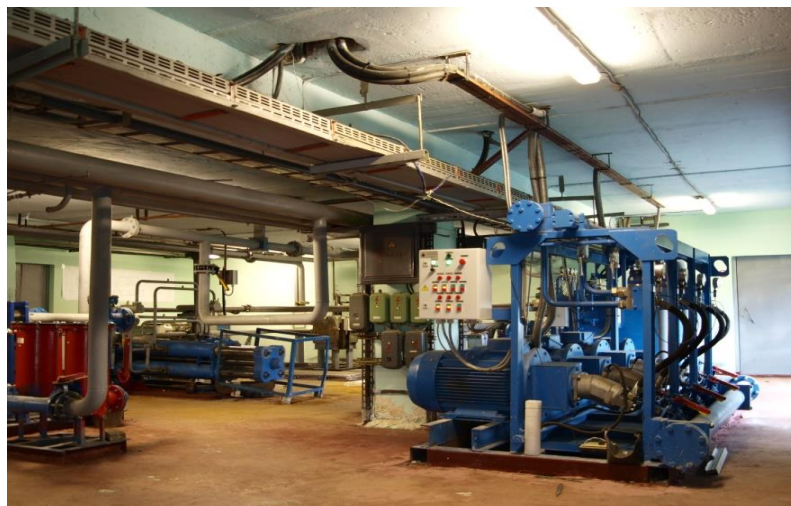
Рис. 1. Гидростанция стенда в помещении лабораторного корпуса ГНЦ ФГУП «ЦНИИ КМ «Прометей».
