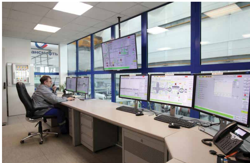
Рис. 3. Центральный пульт управления ИЦ
