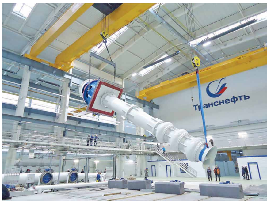
Рис. 2. Вертикальные подпорные насосы испытательного центра
