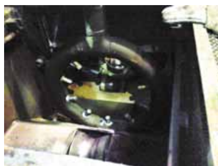
РИС. 4. Камера гидросбива со снятой верхней крышкой
