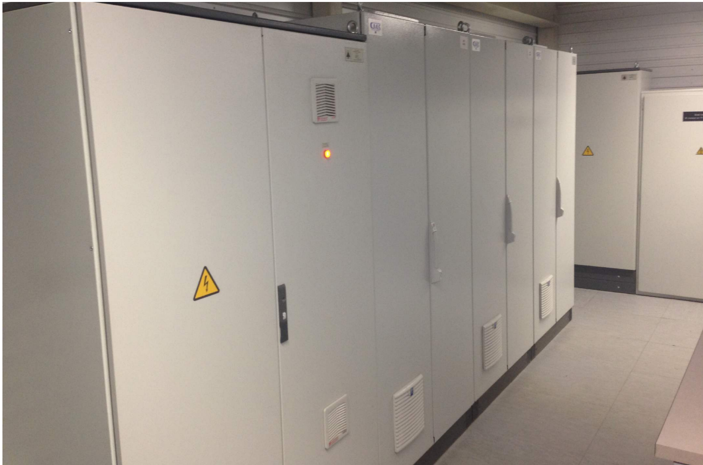
В помещении низковольтного оборудования
