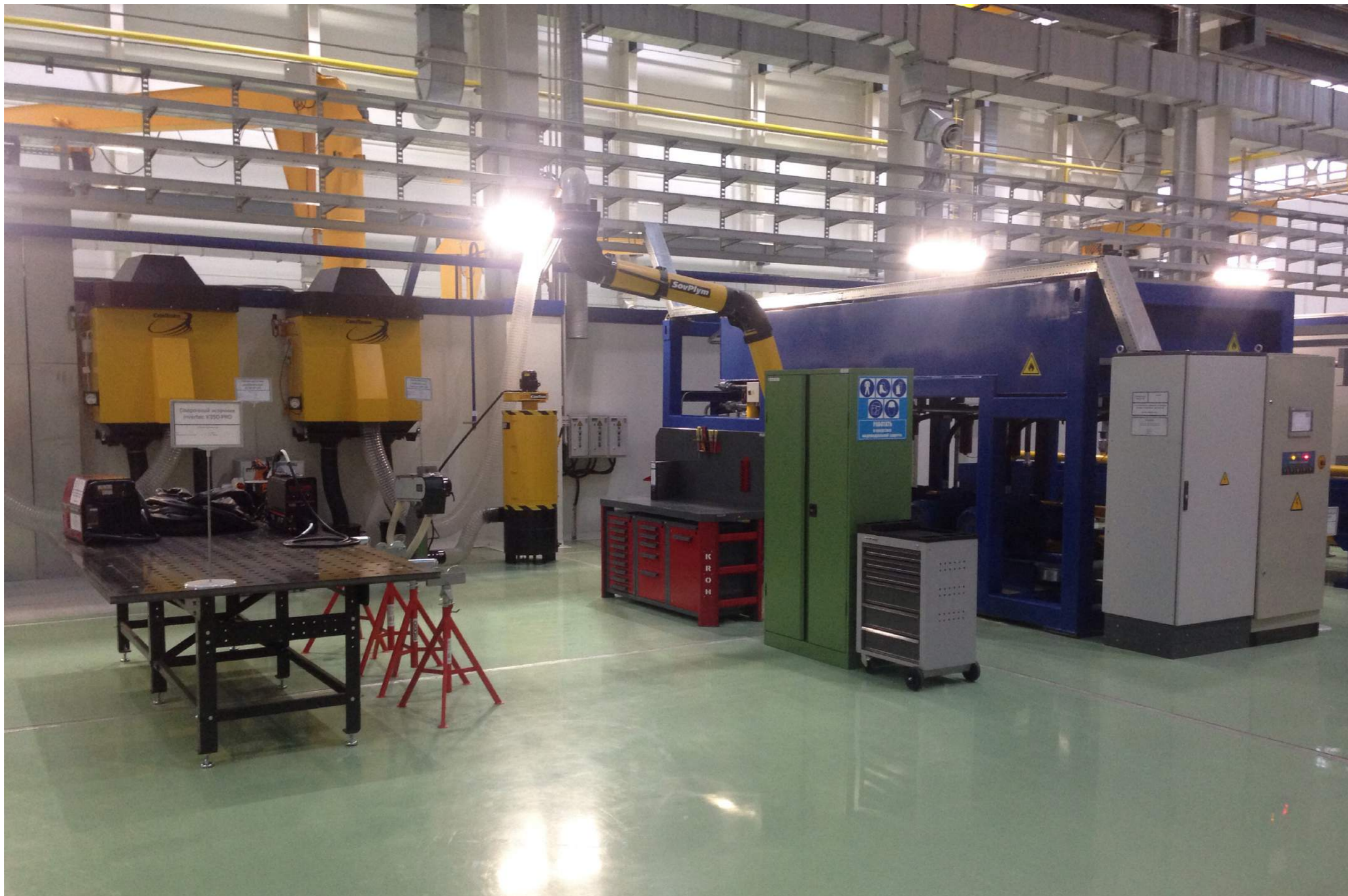
Участок изготовления трубной обвязки системы смазки магистральных насосов
