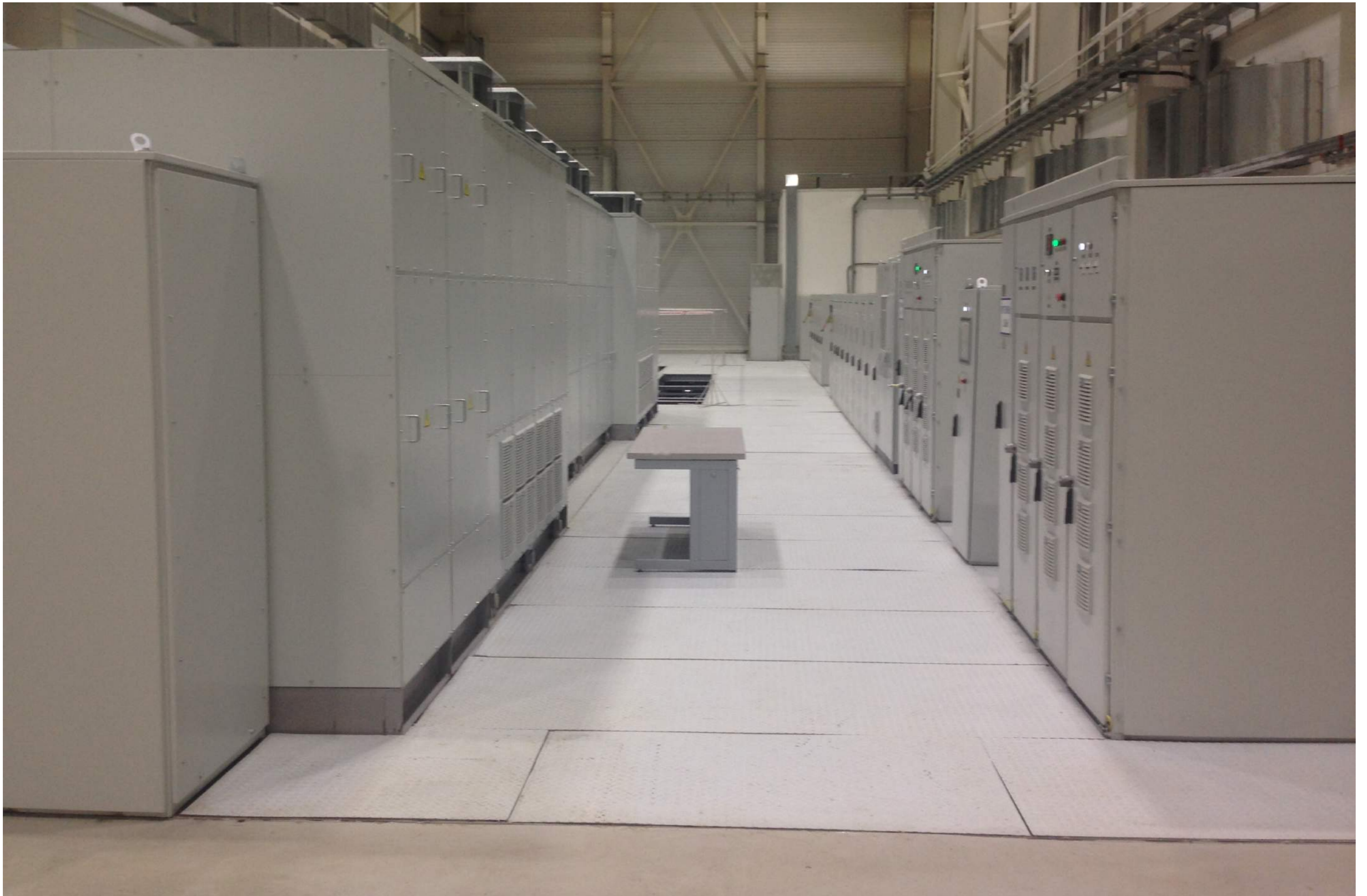
Помещение высоковольтного оборудования
