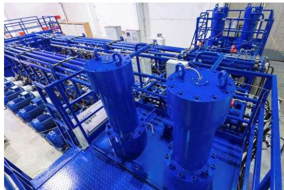
Рис. 4. Вид части насосной установки стенда с гидропреобразователями
