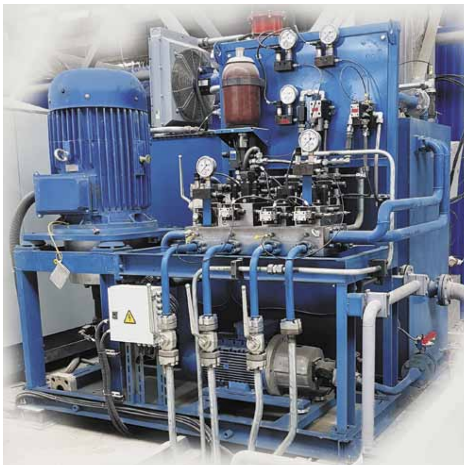
РИС. 3. Насосная установка модернизированной гидросистемы пресса ПЗ15В на участке испытаний готовой продукции ООО «УриЦ»
